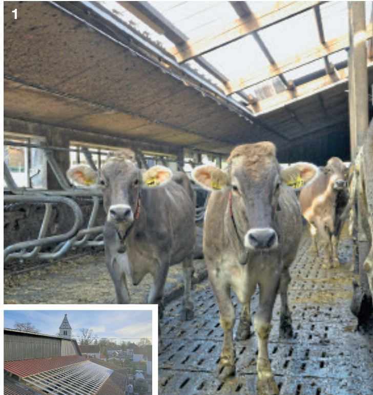
1 Die in das Dach eingebaute, moderne Öffnung erzeugt eine helle und freundliche Atmosphäre. Die Kühe können zwischen verschiedenen Klimabereichen wählen. | Fotos: Benz
